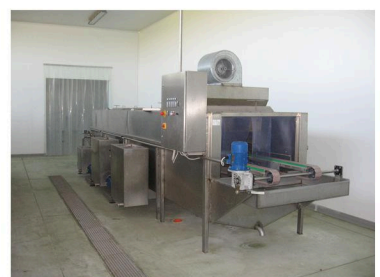
VISTE INTERNE AREA LAVORAZIONE
